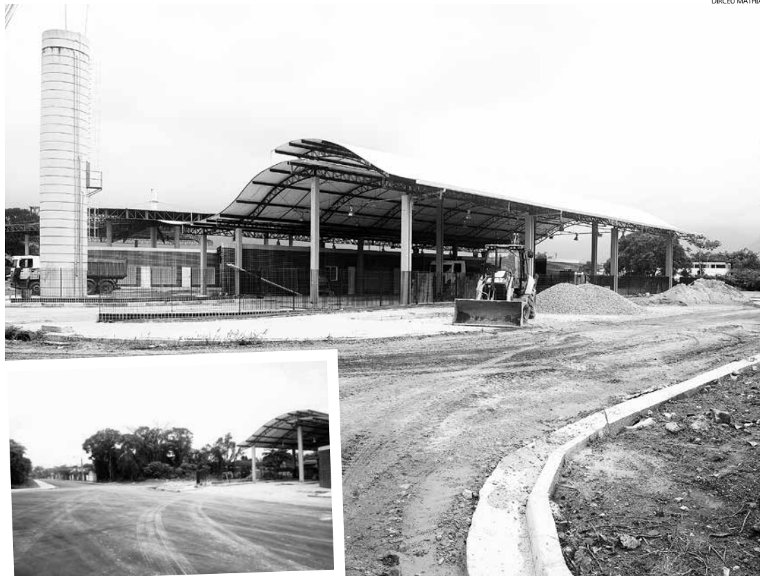
Depois da pavimentação, a próxima etapa será a instalação do sistema de iluminação em todo o prédio do terminal, das calçadas e da avenida marginal, que dá acesso ao local
