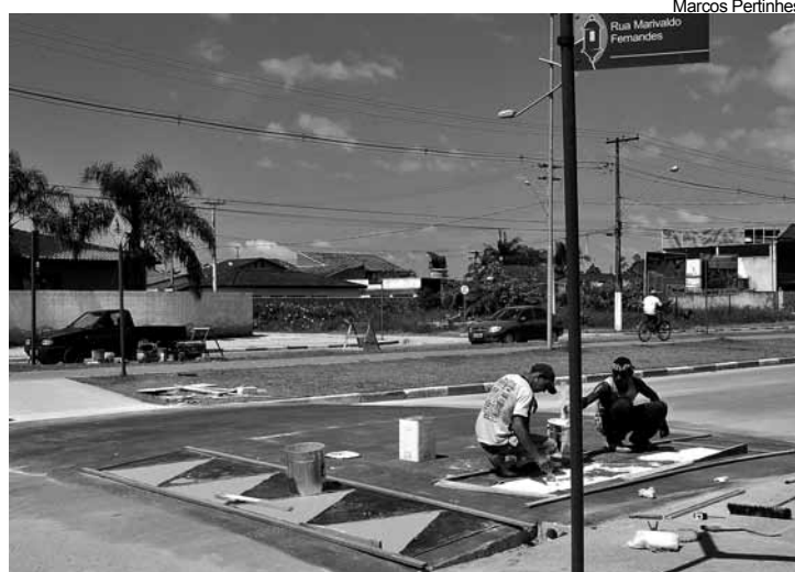
Nos equipamentos foram investidos aproximadamente R$ 150 mil, recursos provenientes do Fundo Municipal de Trânsito (Fumat)
